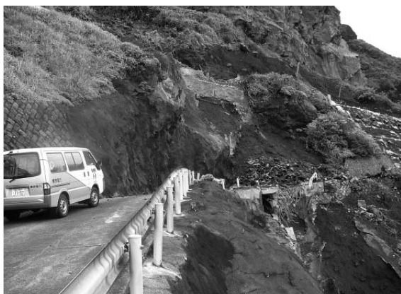
崩落現場（青ヶ島西側斜面）
